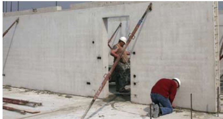
Betonwanden verzorgen van nature stabiele (sub)brandcompartimenten (foto: Marcel van Kerckhoven)
